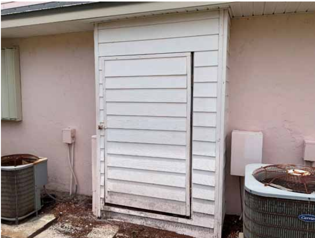
Bldg Electrical Meter Door
